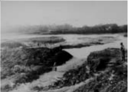
【カスリーン台風】 昭和22年9月撮影 旧海老瀬村地先 渡良瀬川堤防決壊箇所 復旧工事が始まっている
